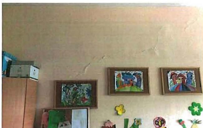
Slika 1. Karakteristično oštećenje: Pukotine u konstruktivnim zidovima.
